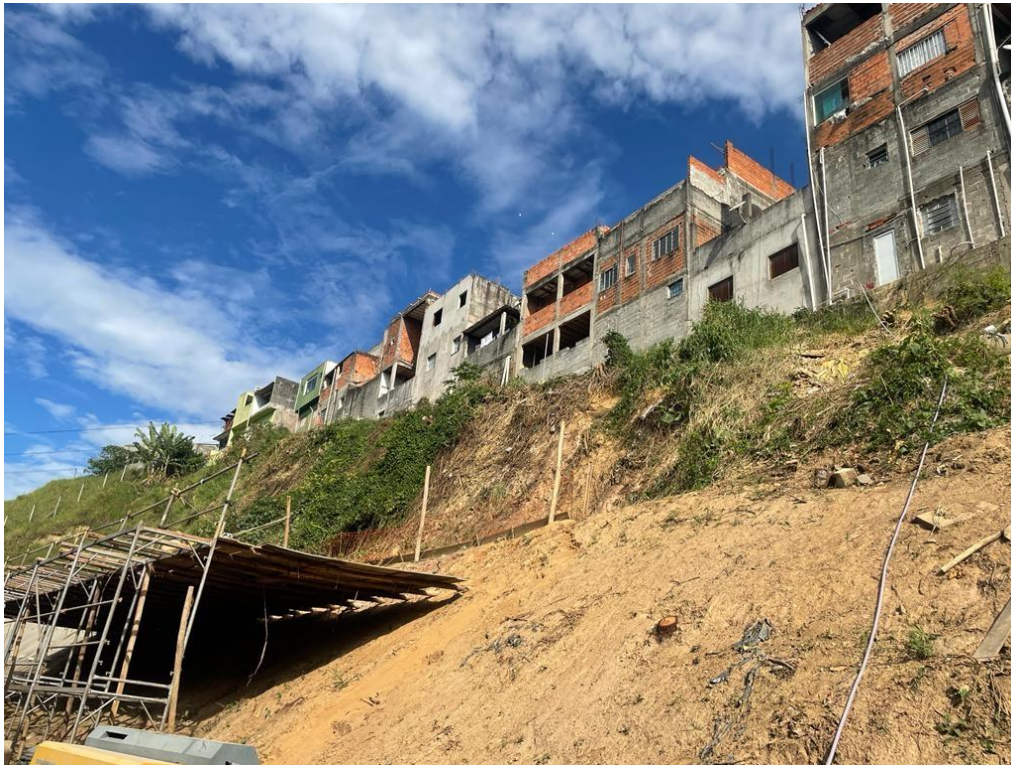
Foto 9 – Parte do talude com contenção ainda não executada
