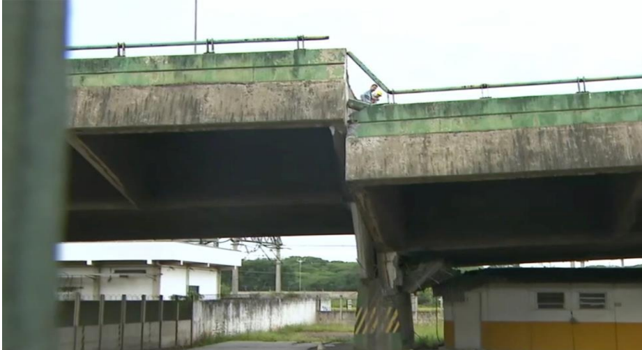
Figura 13 - viga rompida em 15.11.2019 da forma como prevista na vistoria de 19.04.2012
