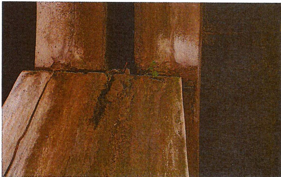
Figura 10 - Grande abertura da junta de dilatação e deslocamento da viga
