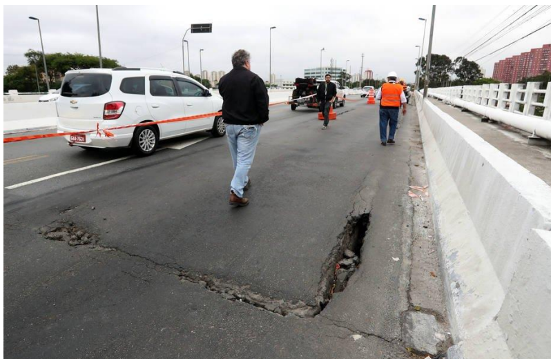
Figura 14 - Fenda no asfalto
