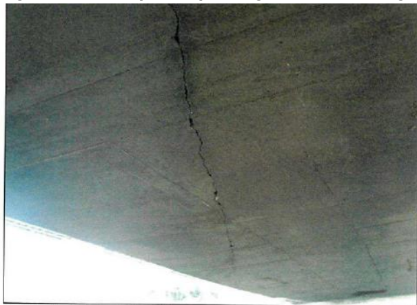
FOTO 49 – Detalhe de trinca diagonal sobre a laje de fundo com infiltração e ação de esforços, que comprometem sua estabilidade da ponte.
