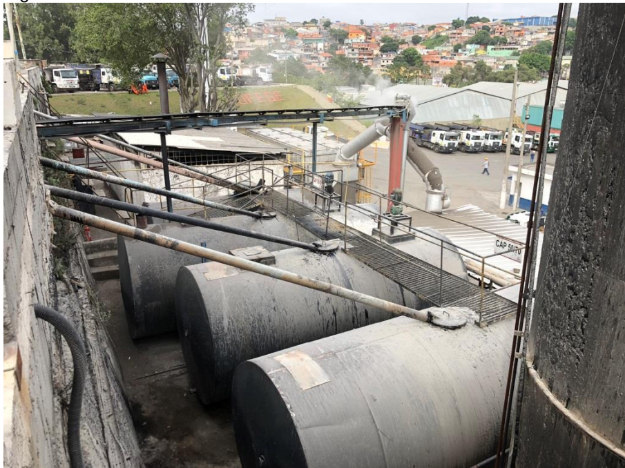
Figura 1 – Reservatórios de armazenamento do CAP
