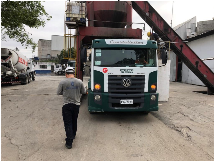
Figura 6 – Silo de carregamento de CBUQ
