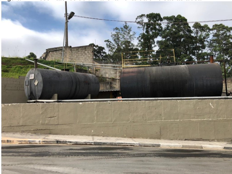
Figura 2 – Reservatórios de armazenamento da emulsão asfáltica
