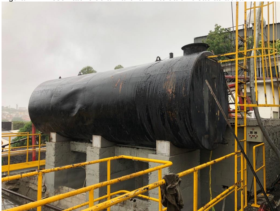
Figura 14 – Reservatório de armazenamento da emulsão asfáltica
