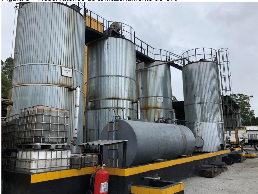
Figura 8 – Reservatórios de armazenamento do CAP
