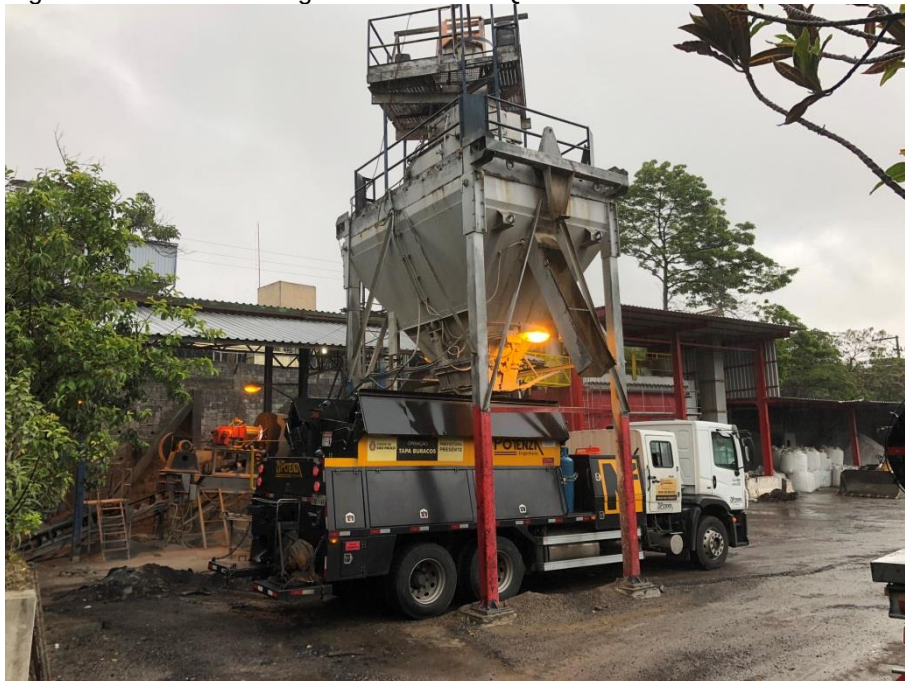
Figura 18 – Silo de carregamento de CBUQ
