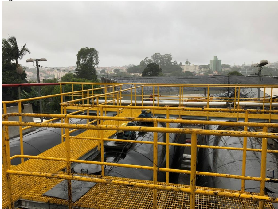
Figura 13 – Reservatórios de armazenamento do CAP
