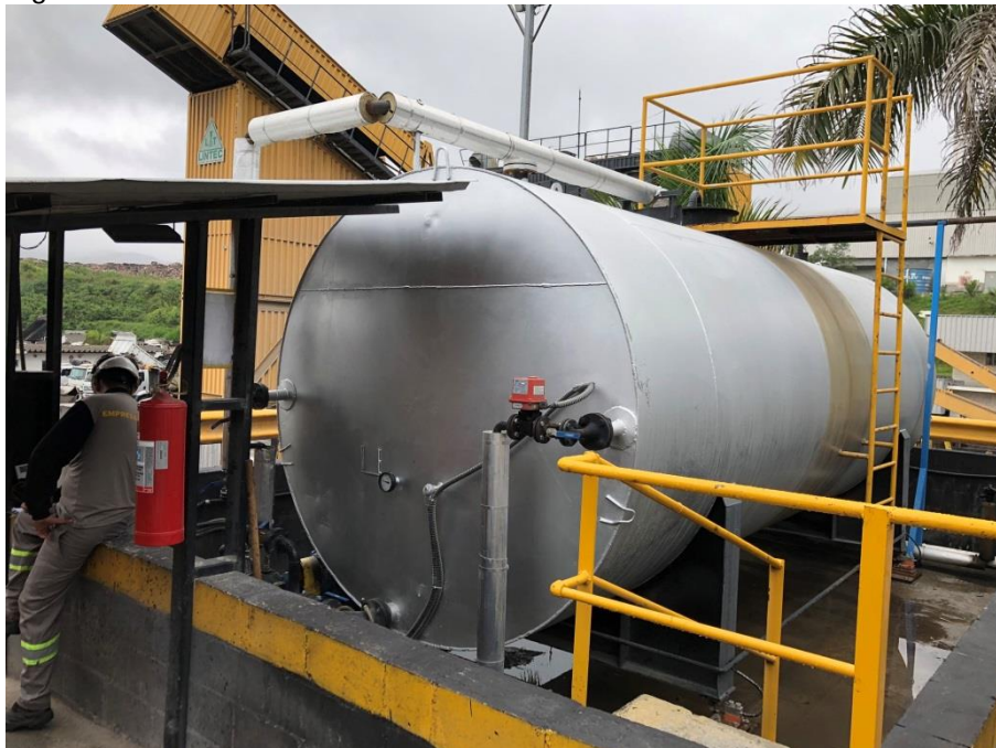
Figura 9 – Reservatórios de armazenamento da emulsão asfáltica
